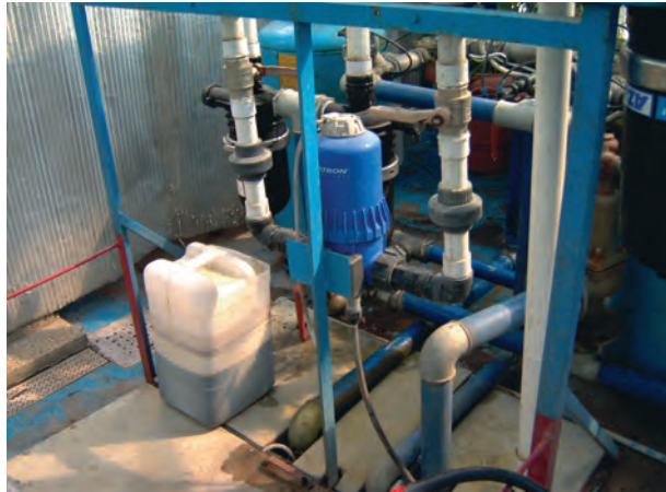
Ryc. 171. Stacja pomp do deszczowania, umożliwiająca również nawożenie dolistne sadzonek
