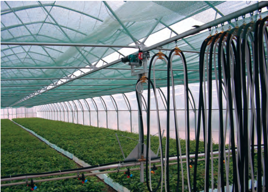
Ryc. 36. Belka deszczująca podwieszona do konstrukcji nośnej tunelu foliowego (fot. Sergiusz Kaczmarzyk)
