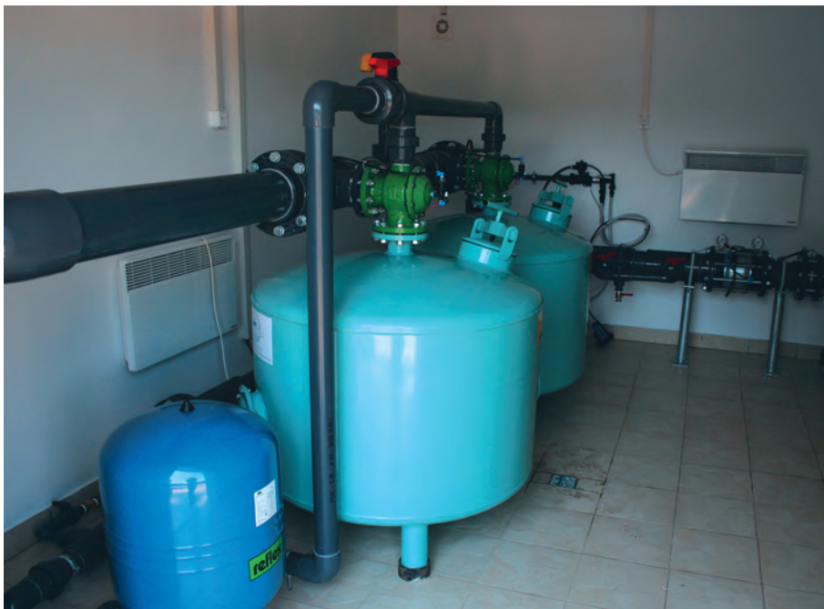
Ryc. 40. Filtry z wkładem żwirowym, piaskowym lub innym, zależnym od rodzaju zanieczyszczeń wody
