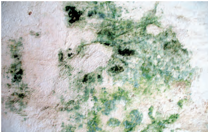
Fot. 6. Pleśnie w budynkach to zawsze zagrożenie dla ludzi alergicy tzw. przestrzeni zamkniętych (fot. P. Kozarski)
